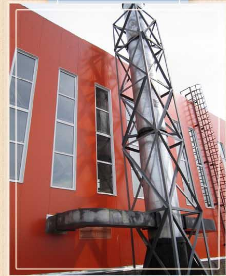
Котельная мощностью 10 МВт обслуживает 2 100 человек населения г. Ветлуга
